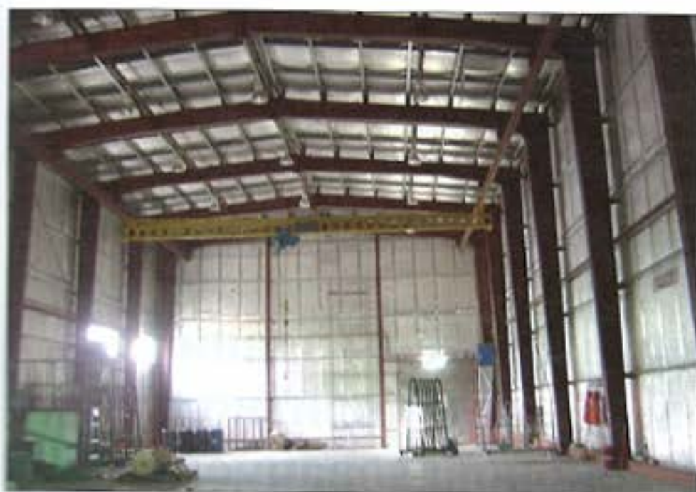
Рис. 4. Вид производственного здания завода ЛИТ с наружными стенами, утепленными материалом Пенофол Супер NEI с отражательной изоляцией из алюминиевой фольги, обращенной внутрь помещения
